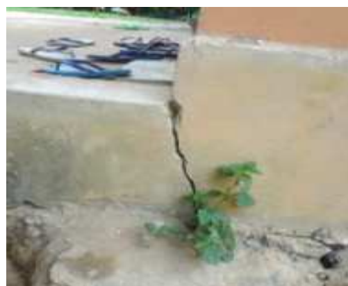
Figura 12: Rachaduras nas casas, causadas pela explosão de dinamites (2). Fonte: Elaborado pelos Autores (2015).
