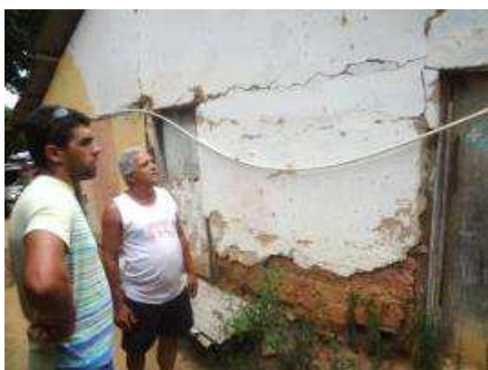
Figura 11: Rachaduras nas casas, causadas pela explosão de dinamites (1). Fonte: Elaborado pelos Autores (2015).
